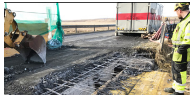
Brúargólf og kantbiti eftir vatnsbrot 08.05.2018.
