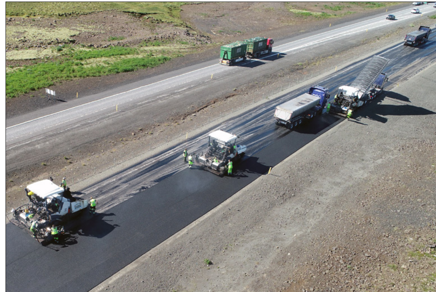
Malbikunarstöðin Hlaðbær-Colas að störfum á Sandskeiði. Þrjár útlagningarvélar hlið við hlið taka allt þversniðið í einu. Drónamyndir, Hallvarður Vignisson, Verkfræðistofan Hnit.
